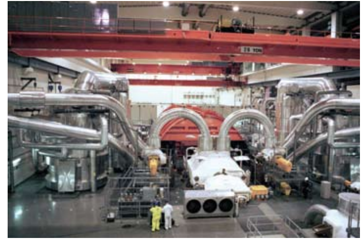
Turbinhall. Bildkälla: Oskarshamns kärnkraftverk
