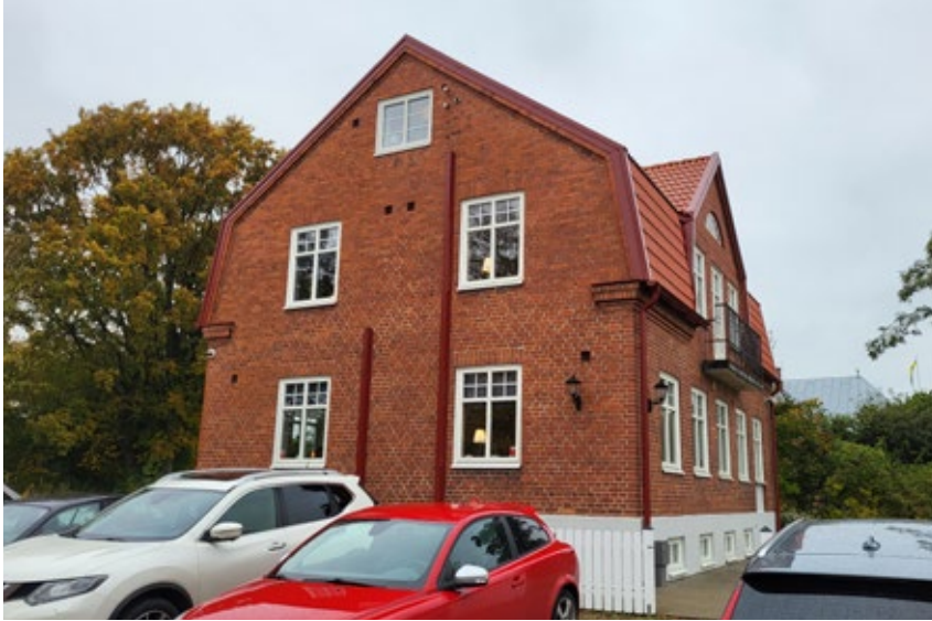
Fasad mot söder. Centralt i fasaden syns kabeldragningar från värmepump inklädda i röd plåt.
